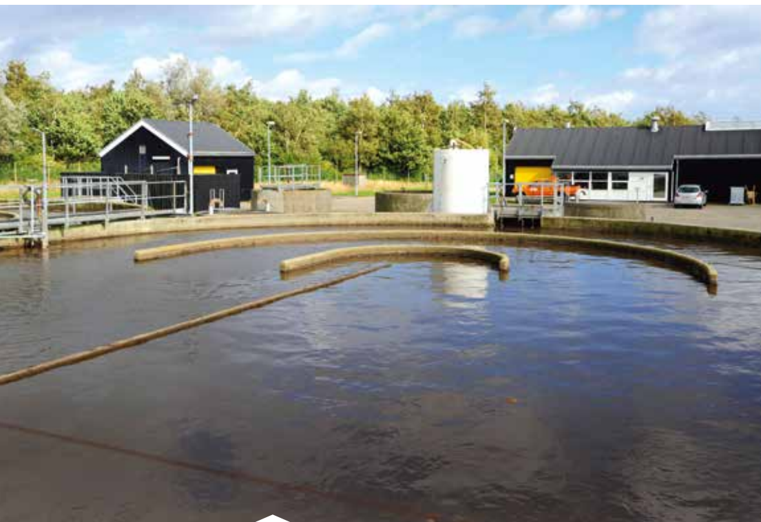
Ringkanalen, som er en biologisk procestank, samt driftsbygninger på Frejlev renseanlæg.
