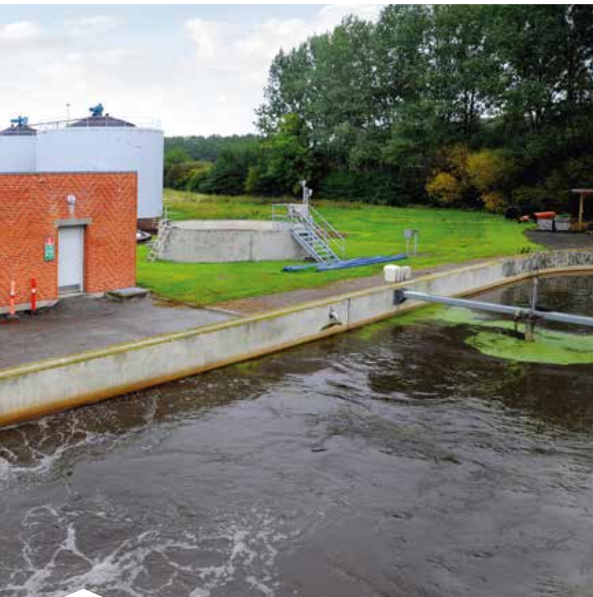
Procestank, driftsbygning samt rådnetanke på Nykøbing F. rensesanlæg.
